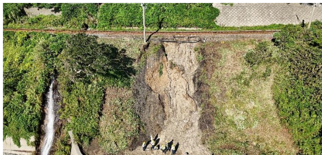
写真-1 盛土崩壊状況
