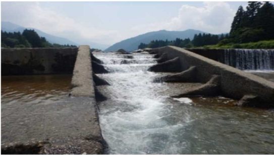
図 4 損傷した水路階段式魚道
