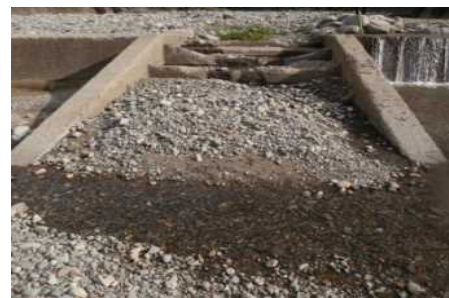
図3 魚道内に土砂が堆積し、流水が流下不可。
