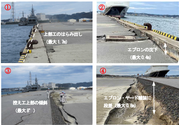
図-4 物専岸壁の被災状況
