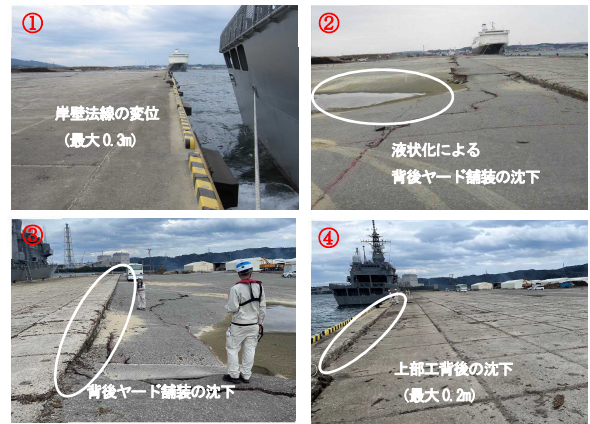
図-5 2号岸壁B区の被災状況
