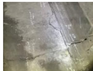
写真-1 路盤ひび割れ
