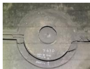
写真-3 突起コン隙間
