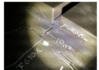
写真-2 床板継目段差
