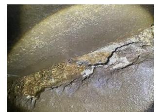
写真-4 ドレーン破損
