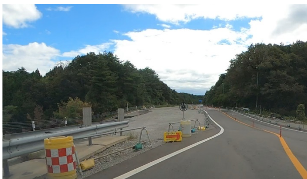
図 3 下流の方向へ斜面崩壊が起きている点
