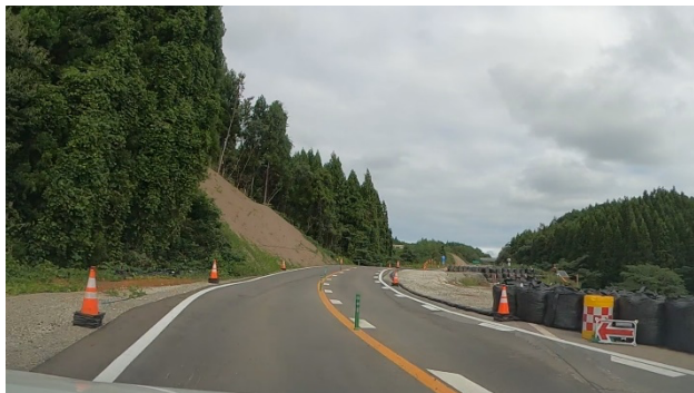
図 4 上から土砂が崩れてきたと考えられる点
