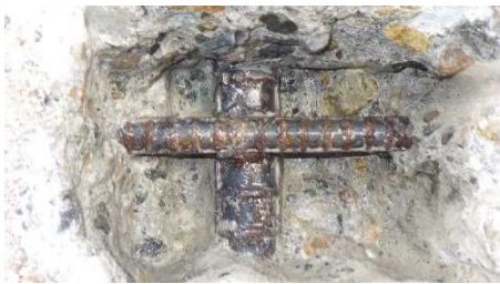
写真4 門柱鉄筋腐食状況
