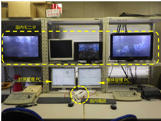
写真-6 計測管理室のモニタ類
