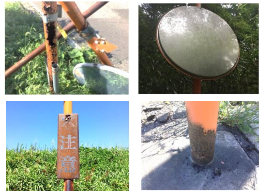
図-3 特徴的な損傷写真の例
