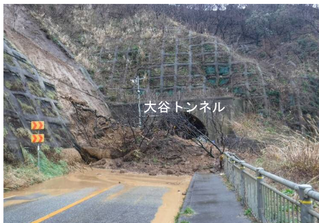
写真 1. 土砂崩壊発生状況（側面）
