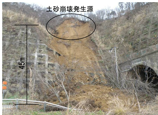
写真 2. 土砂崩壊発生状況（正面）
