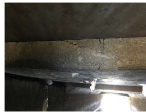
写真-3 ひび割れの例
