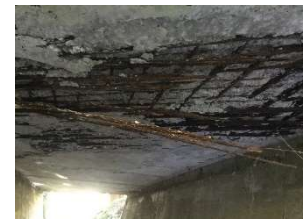
写真-4 剥離・鉄筋露出の例
