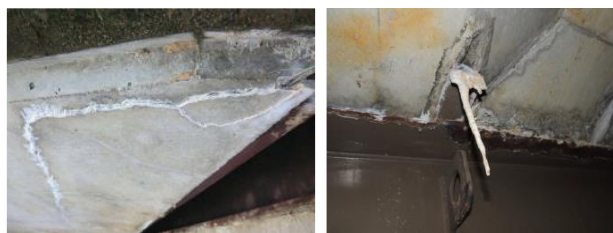
写真-3 漏水・遊離石灰の例
