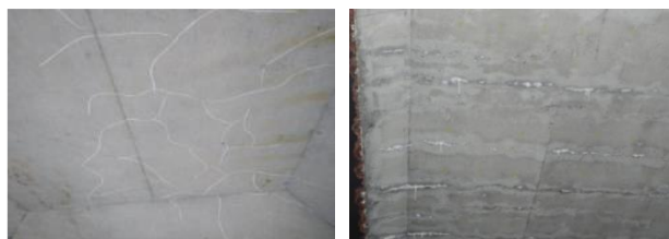
写真-1 床版ひびわれの例
