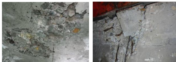
写真-2 剥離・鉄筋露出の例
