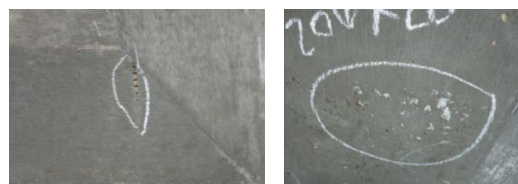
写真-4 ごく一部の鉄筋が露出している損傷
