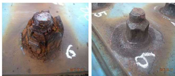
ケレン前 ケレン後 図1 ナットの腐食減肉状況
