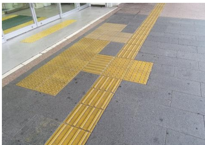
図5 必要以上の警告ブロック設置
