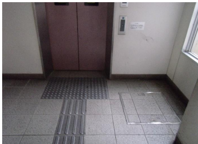
図6 エレベータ前の誘導用ブロック設置状況
