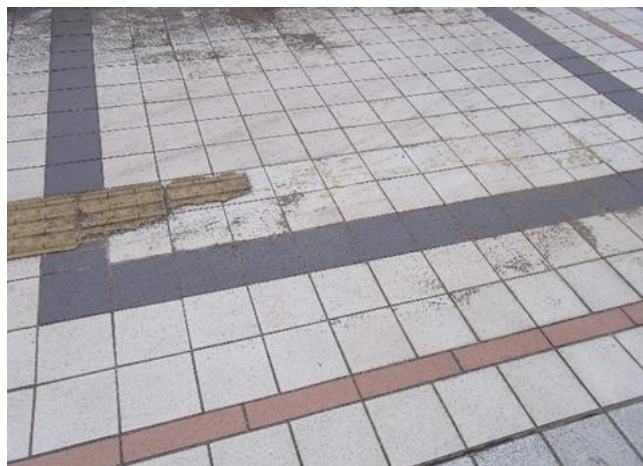
図3 材質と破損による連続性の欠如
