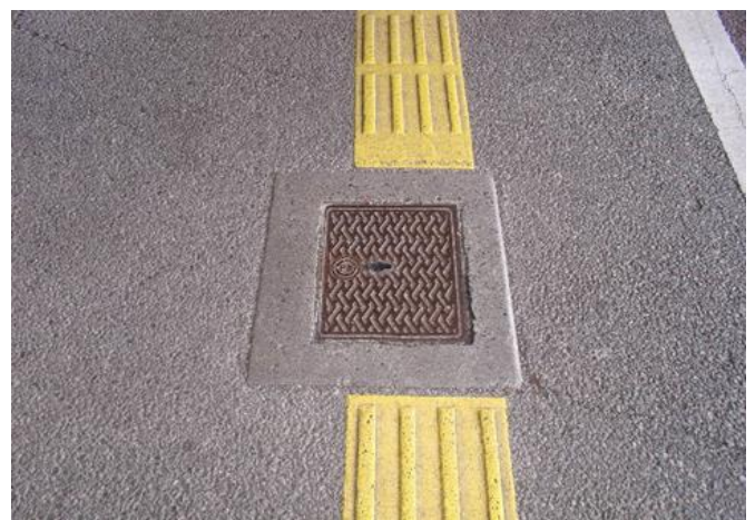
図1 マンホールによる連続性の欠如
