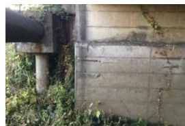
図-3 下部構造の損傷写真
