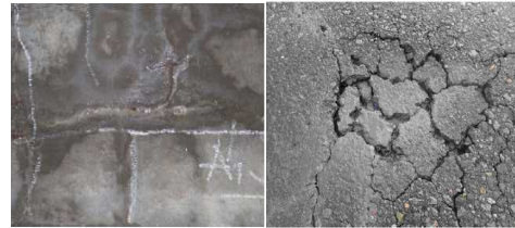
写真-1 長岡大橋の損傷状況（左：床版下面 右：舗装表面）
