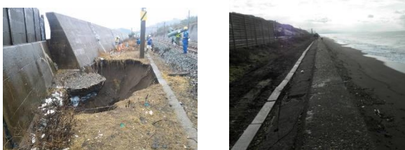
写真2 B地点護岸壁裏陥没（左）と検知線設置（右）
