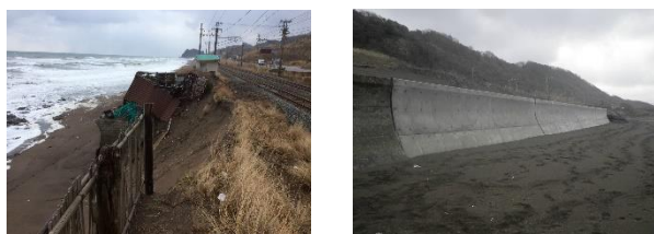
写真3 C地点のり面浸食・陥没（左）と護岸壁新設（右）
