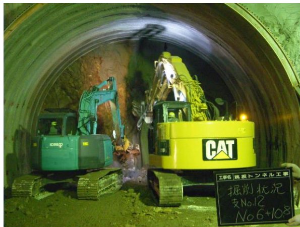
写真-2 既設隧道覆工コンクリート破碎
