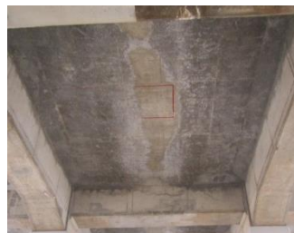
写真-2 一次調査時の状態
