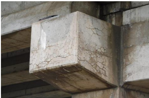
写真-1 ASR 変状例
