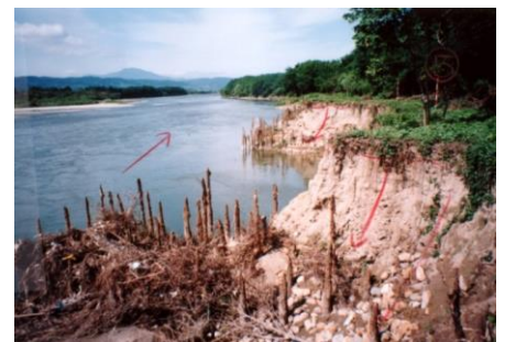
写真1 平成7年村山橋の上流で決壊した河岸から現れた杭出水制
