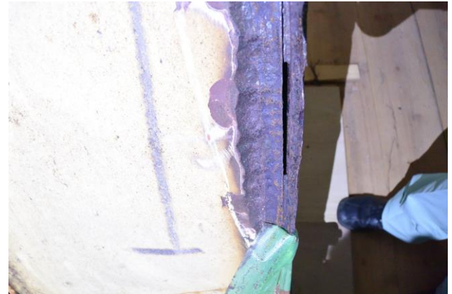
写真-1 すみ肉溶接部の腐食切れの一例
