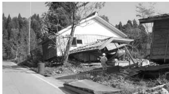
図-2 家屋の被害写真 3) より引用
